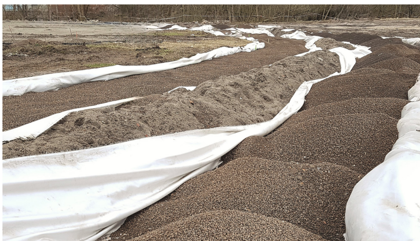
El Leca LWA compactado (8/10 mm–20 mm) encerrado en material geosintético forma "colchones de árido de arcilla expandida" reductores de carga.
