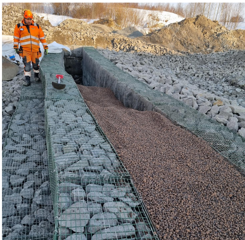
Leca LWA colocada en el núcleo de la presa, fácil de sustituir.
