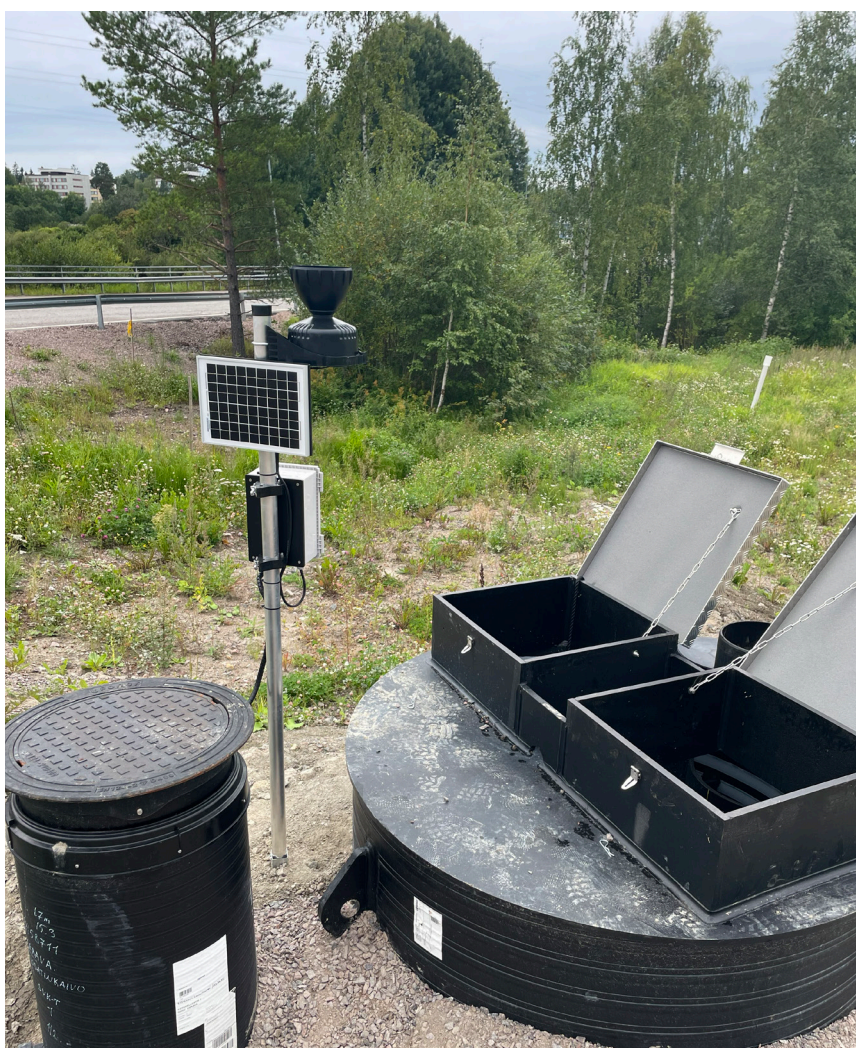
La cámara de filtrado combina la sedimentación y la filtración con Filtralite P.
