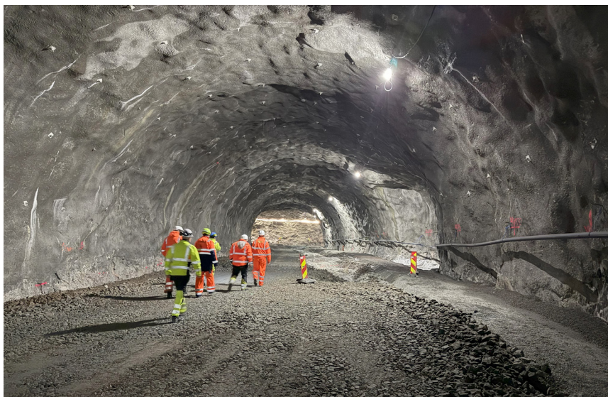
Equipo del proyecto in situ en el túnel de Brattfjell, donde se utiliza LWA para la protección contra las heladas y el drenaje.
