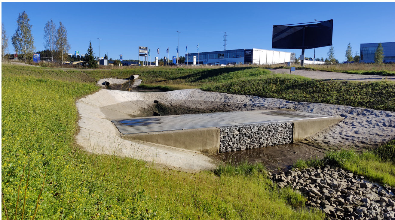
En Nikkilä, la presa con filtro completa el tratamiento.
